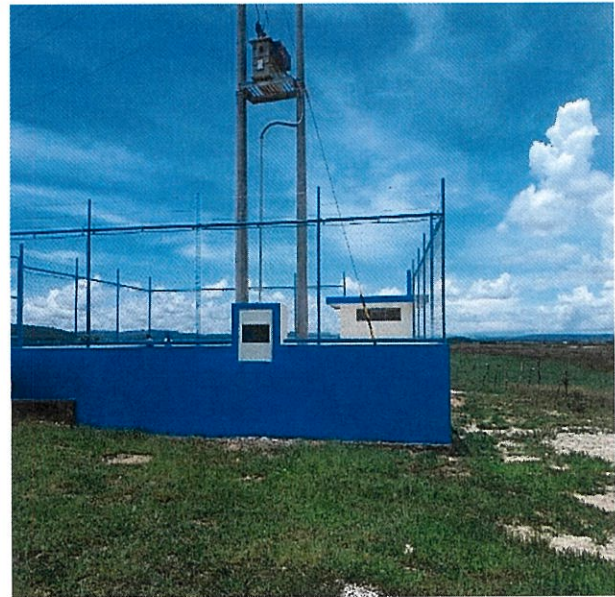
Equipamiento de pozo profundo, Segunda Etapa, Ejido Francisco Sarabia
