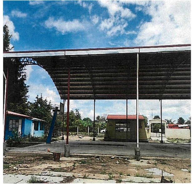
Construcción de Techado en áreas de impartición de Educación física en Escuela Primaria "Margarita Maza de Juárez" con Clave:07dbr0874z, en Ranchería el Rosario
