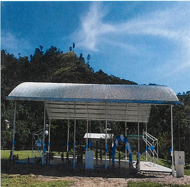
Construcción de Techado en áreas de impartición de Educación física en Escuela Primaria "Cursos Comunitarios" con Clave:07kpr14546, En Ranchería Nuevo Mundo el Naranja
